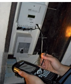
Mise en place d'un compteur communicant.
